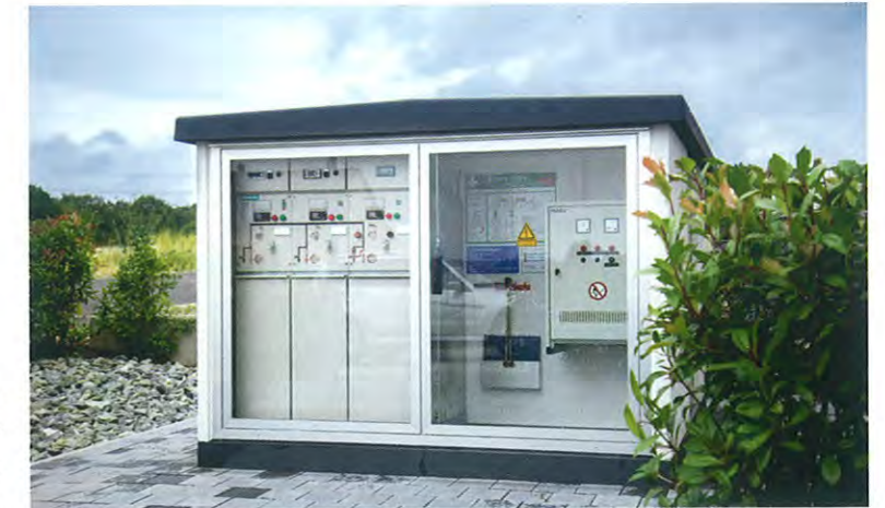
Durch intelligente Ortsnetzstationen lässt sich die Stromverteilung in den Netzen besser steuern. Sie sind deshalb ein wichtiger Teil des Smart Grids.
