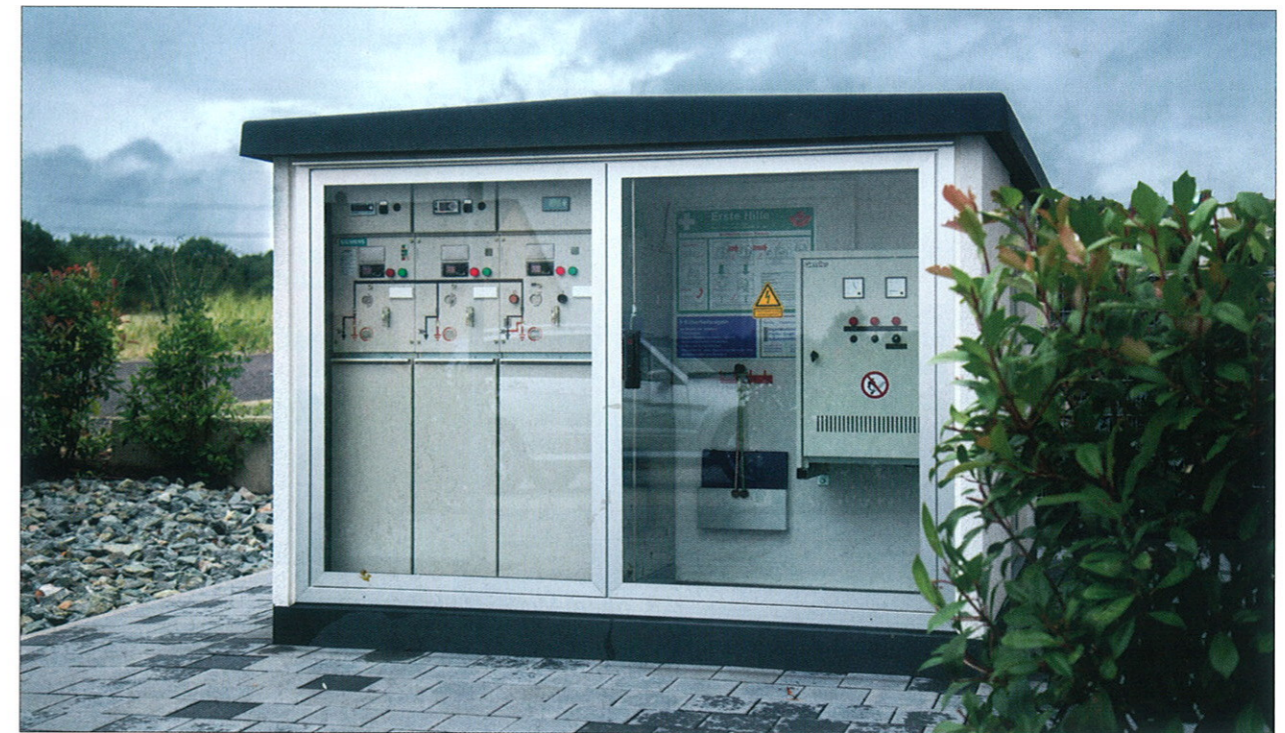
Mit ihr wird das Stromnetz smart: Die intelligente Musterstation des Ingenieurbüros Pfeffer ermöglicht mit Komponenten von Wago das Messen, Steuern, Regeln und Fernwirken und arbeitet zum Teil automatisiert. Die fabrikkompakte Bauweise wird allen normativen Anforderungen gerecht.
