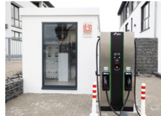
Digitale Ortsnetzstation mit Ladesäule
